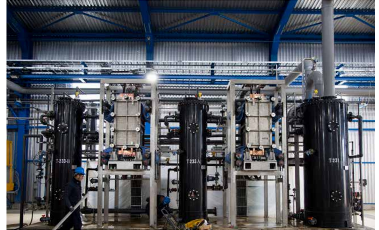
Ak-Kim Ultrafiltrasyon Tesisi
